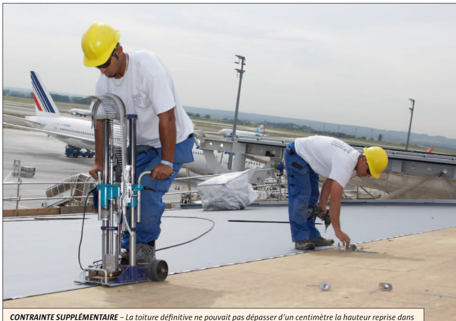
CONTRAINTE SUPPLÉMENTAIRE – La toiture définitive ne pouvait pas dépasser d'un centimètre la hauteur reprise dans le cahier des charges afin d'assurer la vue dégagée promise aux contrôleurs aériens.
