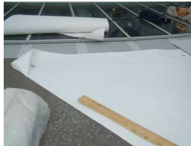
Het geotextiel scheidingsvlies werd tweelaags aangebracht om de oneffenheden in de oude dakhuid zo goed mogelijk te compenseren en werd schuin verneden om zoveel mogelijk snijafval te voorkomen.
